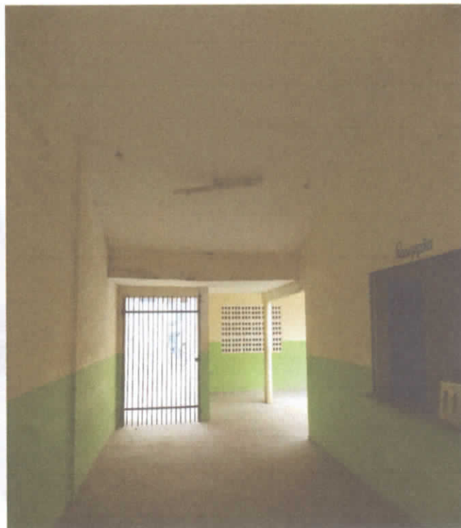
Hall com pintura danificada
