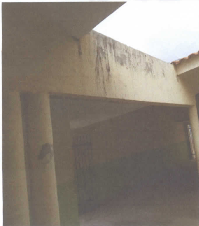
Viga com pintura danificada
