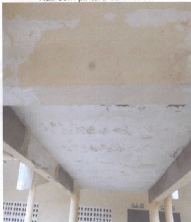
Laje com pintura danificada
