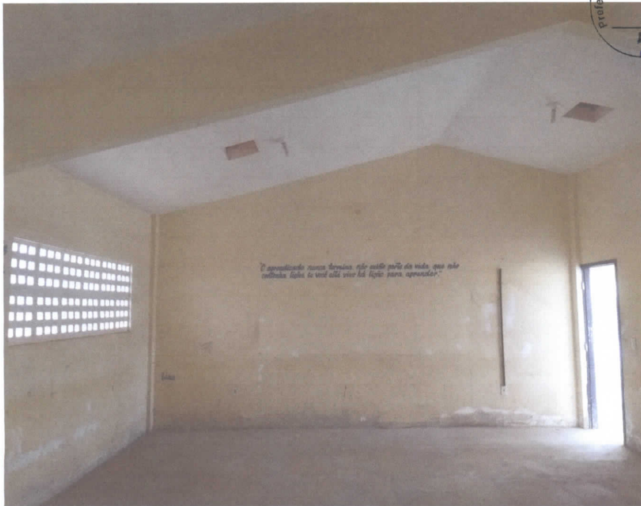
Sala de aula com pintura danificada e piso sem polimento.
