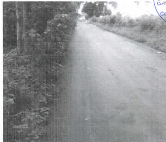
INICIO DO TRECHO DA 2ª ETAPA DA OBRA-COORD. UTM: 280248.46-X/9586786.51-Y-FOTO TIRADA VOLTANDO
