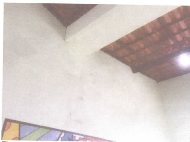
Figura 10 - Calha com Infiltração
