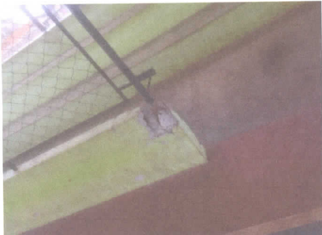
Figura 11 - Reboco quebrado com armadura exposta
