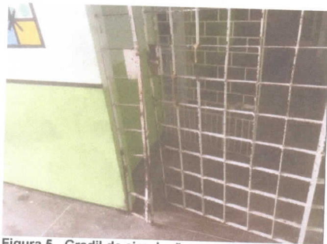
Figura 5 - Gradil de circulação com violação
