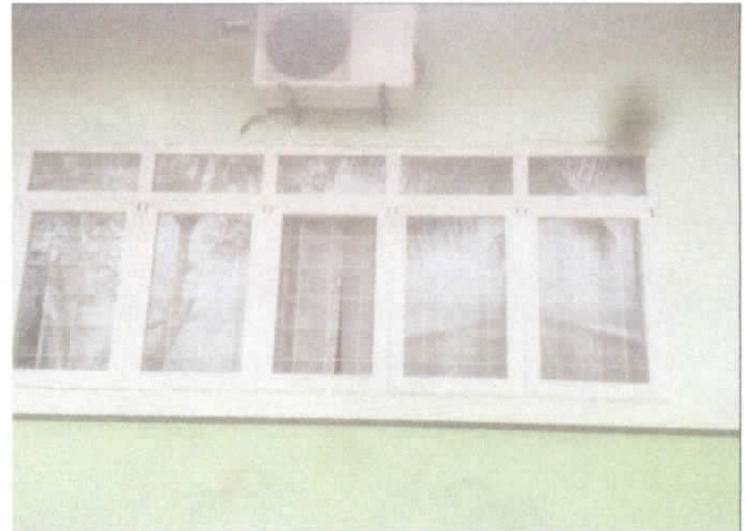
Figura 26 - Esquadrias danificadas Coordenação
